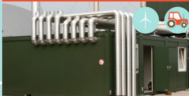
Biogasinstallatie Agro Giethoorn, Steenwijkerland
